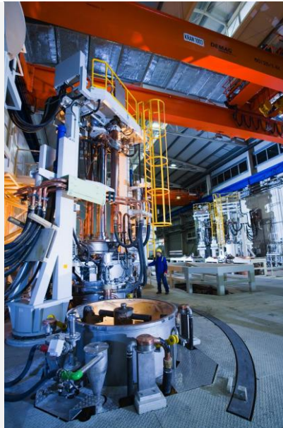
ESU-Anlage (voestalpine Böhler Edelstahl)
