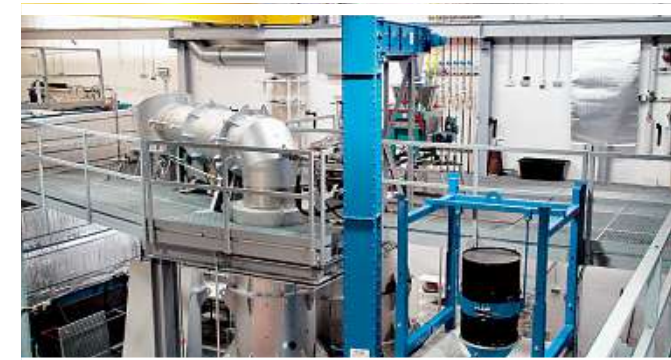
Die Flash-Reaktor-Pilotanlage im Technikum der Montanuniversität
