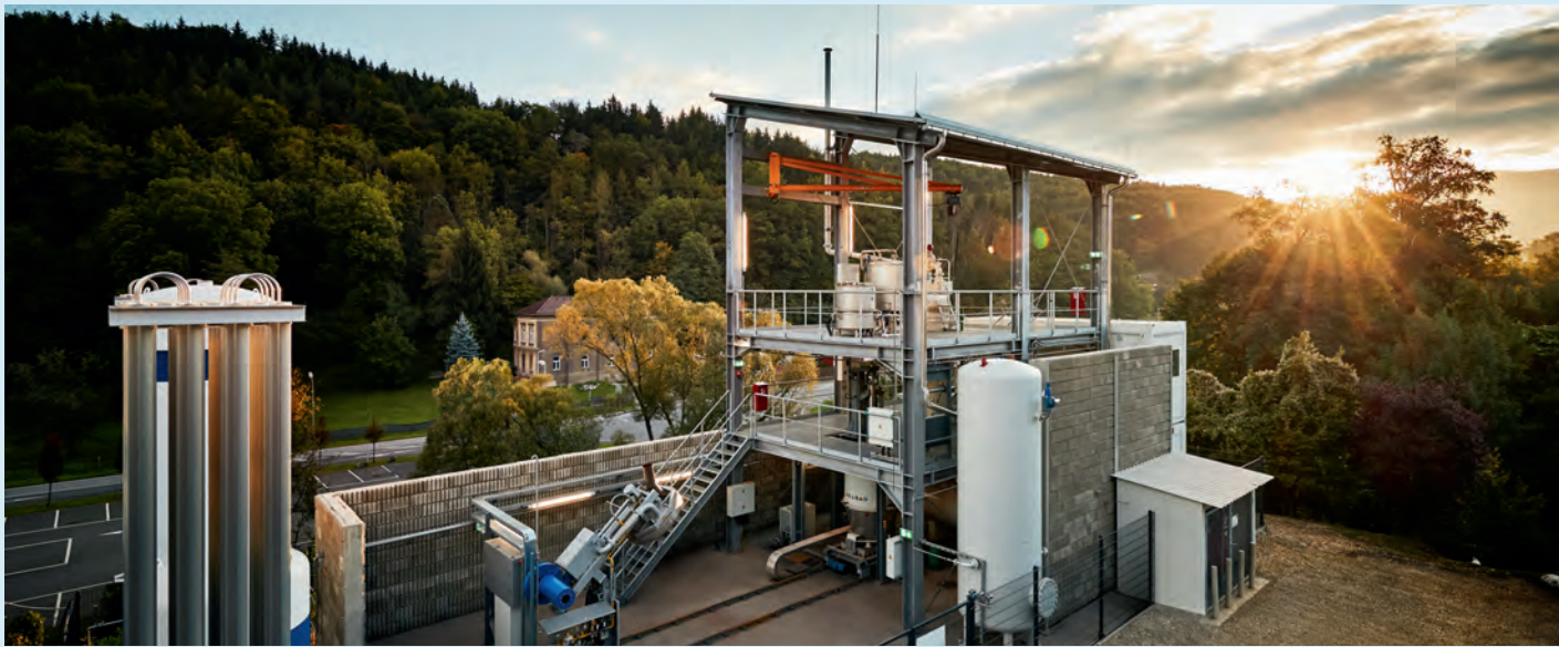
Abb. 17: HPSR-Pilotanlage. Quelle: voestalpine Stahl Donawitz GmbH
